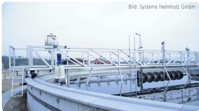
Bild 3: Eines der neuen Nachklärbecken in Fürstentwalde.
