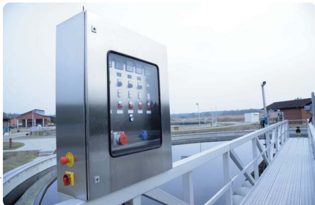
Bild 2: Eines der neuen Nachklärbecken in Fürstenwalde.
