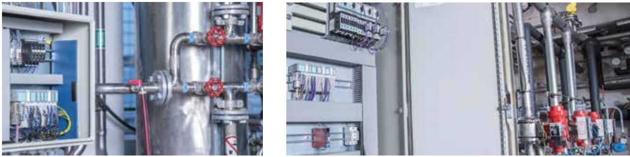
02 Das TB20 kommt bei Rudolf aktuell bei Vakuumpumpen und bei der Steuerung der Kondensatanlage zum Einsatz
